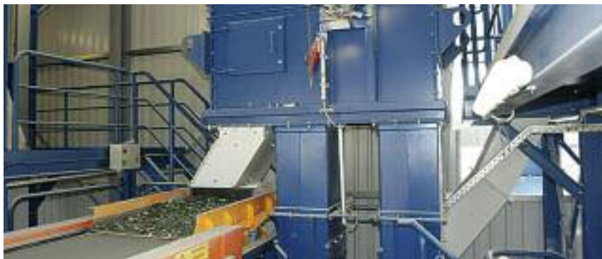
Ein Detail aus der Aufbereitungsanlage von KWB Planreal AG in Immendingen (D) im grenznahen Raum zu Schaffhausen. www.kwbplanreal.ch
